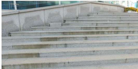
<석재공사 하자발생 : 위 사진과 같이 세면물이 흘러나와 접착이 약해져서 석재 탈락또석재파손으로이어질수 있음>
